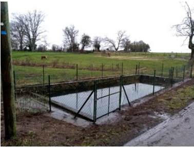
Bruno et Patrick ont remis en état le lavoir situé à Saint Mamet
